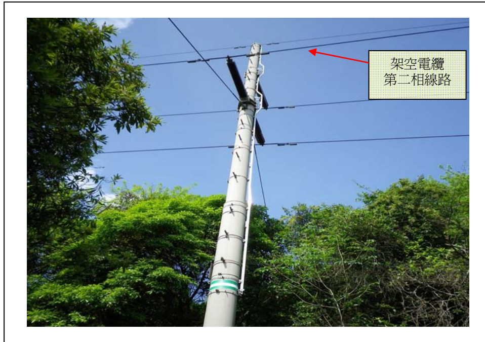
圖三： “粉嶺 - 汀角路 (十三萬二千伏特) 第一架空線路 (“FNL-TKR No. 1 Circuit”) ” 第9號電棟
