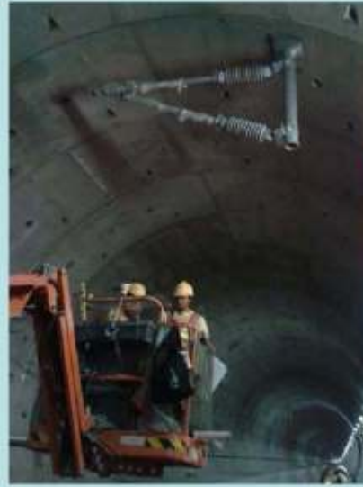
高架電纜懸臂 OHL Cantilever
