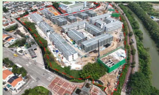
元朗攸樂路「簡約公屋」項目工程進展 (截至2024年9月) Construction Progress of LPH Project at Yau Pok Road, Yuen Long (as of Sep 2024)
